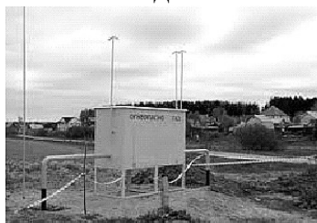
Газораспределительные пункты и щиты
